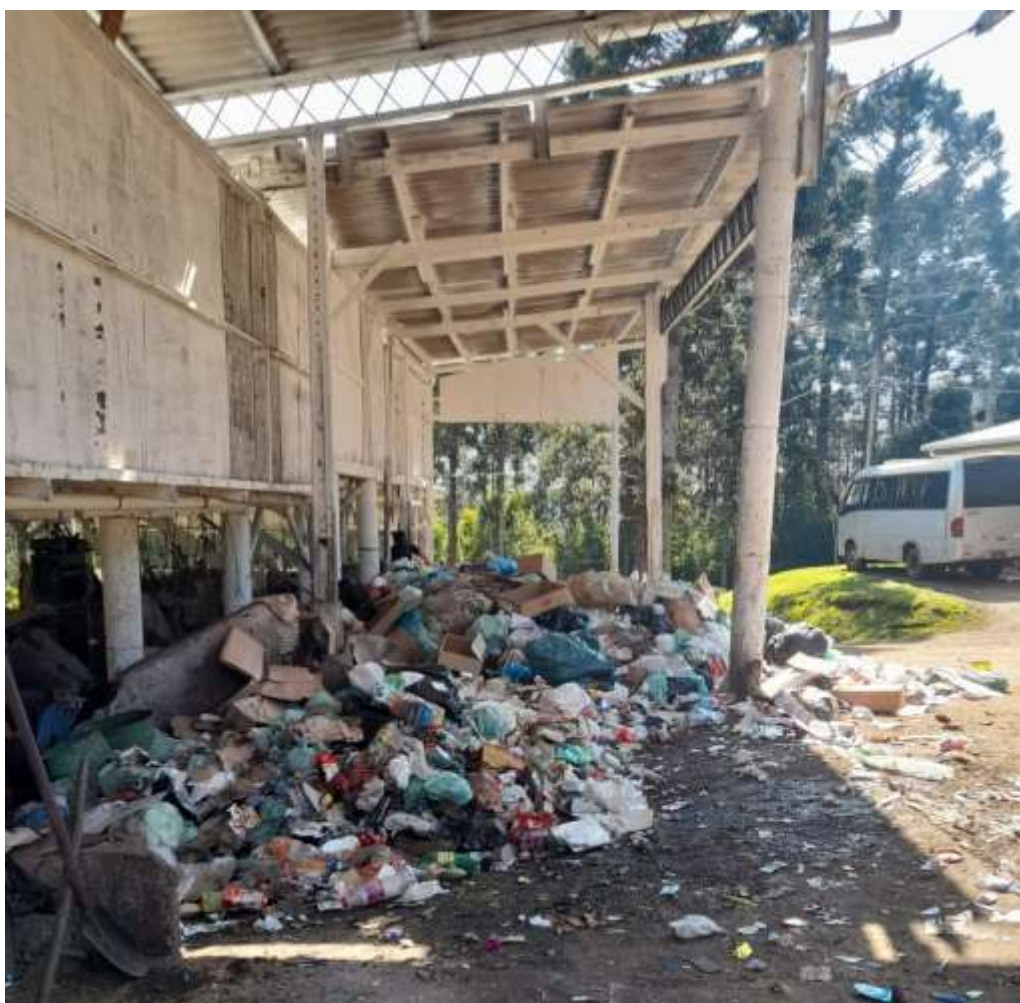
Figura 18 - Área de recebimento dos resíduos
